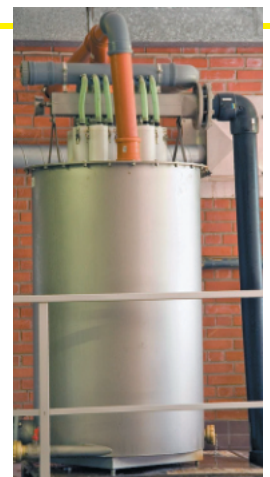
EFEKTYWNY™ Installed at Skurups Water
